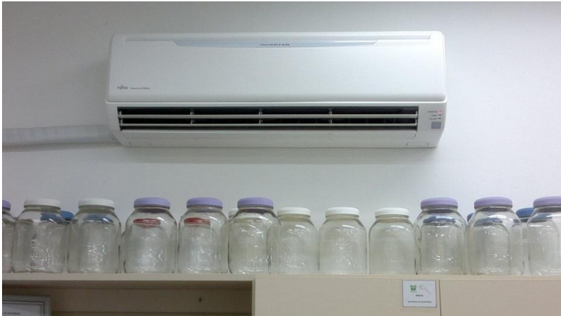
Condicionador de ar principal.
