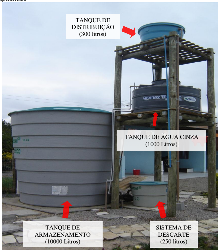
Figura 5: Armazenamento e descarte do sistema de aproveitamento de chuva implantado
