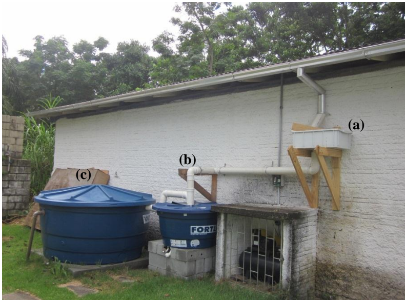
Figura 8: Fotografia do sistema de captação de água de chuva: a) remoção de folhas, b) dispositivo de descarte da primeira fração da água, c) armazenamento.
