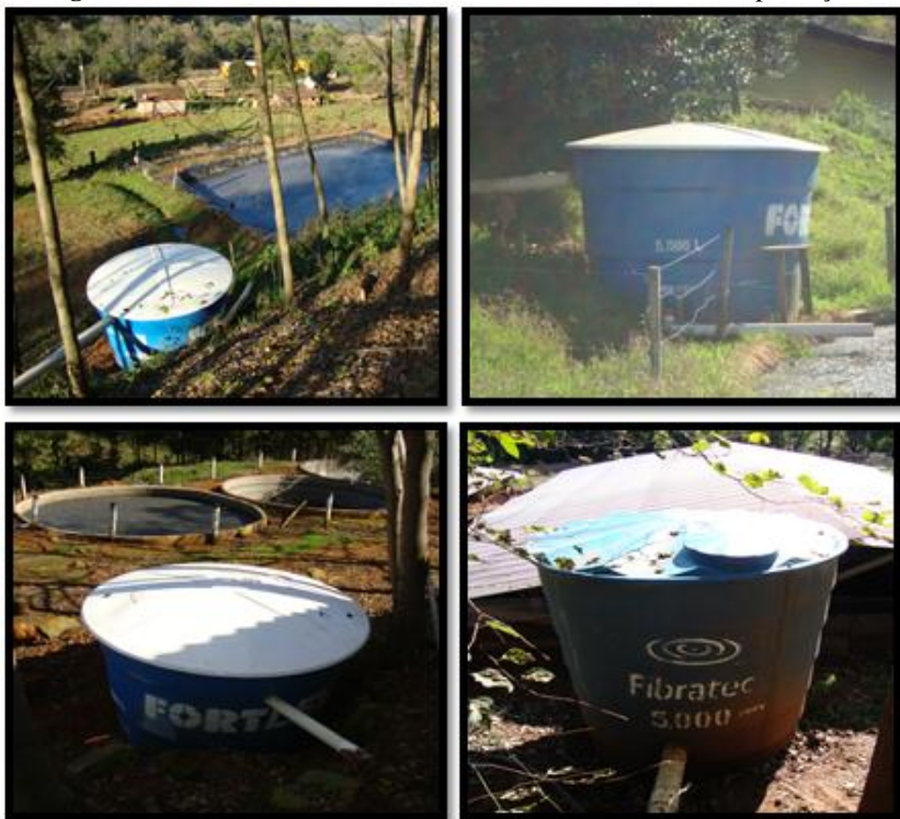
Figura 22 - Caixas de fibra de vidro instaladas nas unidades de produção.
