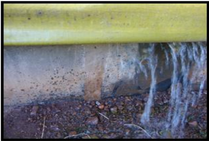
Figura 7 - Desperdício de água na unidade devido à falta de manutenção do sistema hidráulico.
