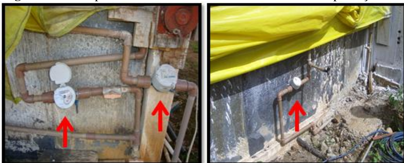
Figura 16 - Exemplos de hidrômetros instalados nas unidades de produção.
