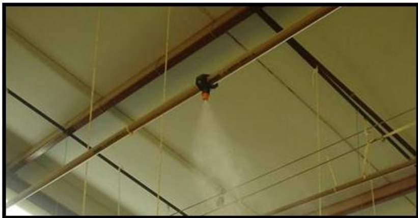
Figura 10 - Nebulizador no interior de uma unidade suinícola.
