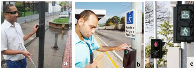
Figura 92: Semáforo temporizador com indicação sonora para pedestres.
