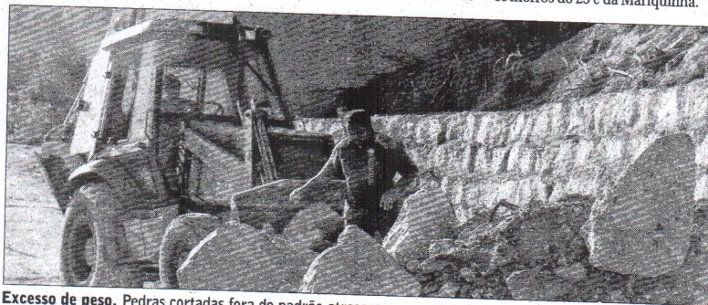
Excesso de peso. Pedras cortadas fora do padrão atrasaram a construção do muro de contenção de encostas
