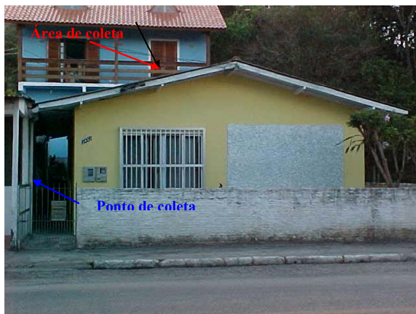
Figura 11: Residência de telhado de amianto onde foi realizada a coleta das amostras
