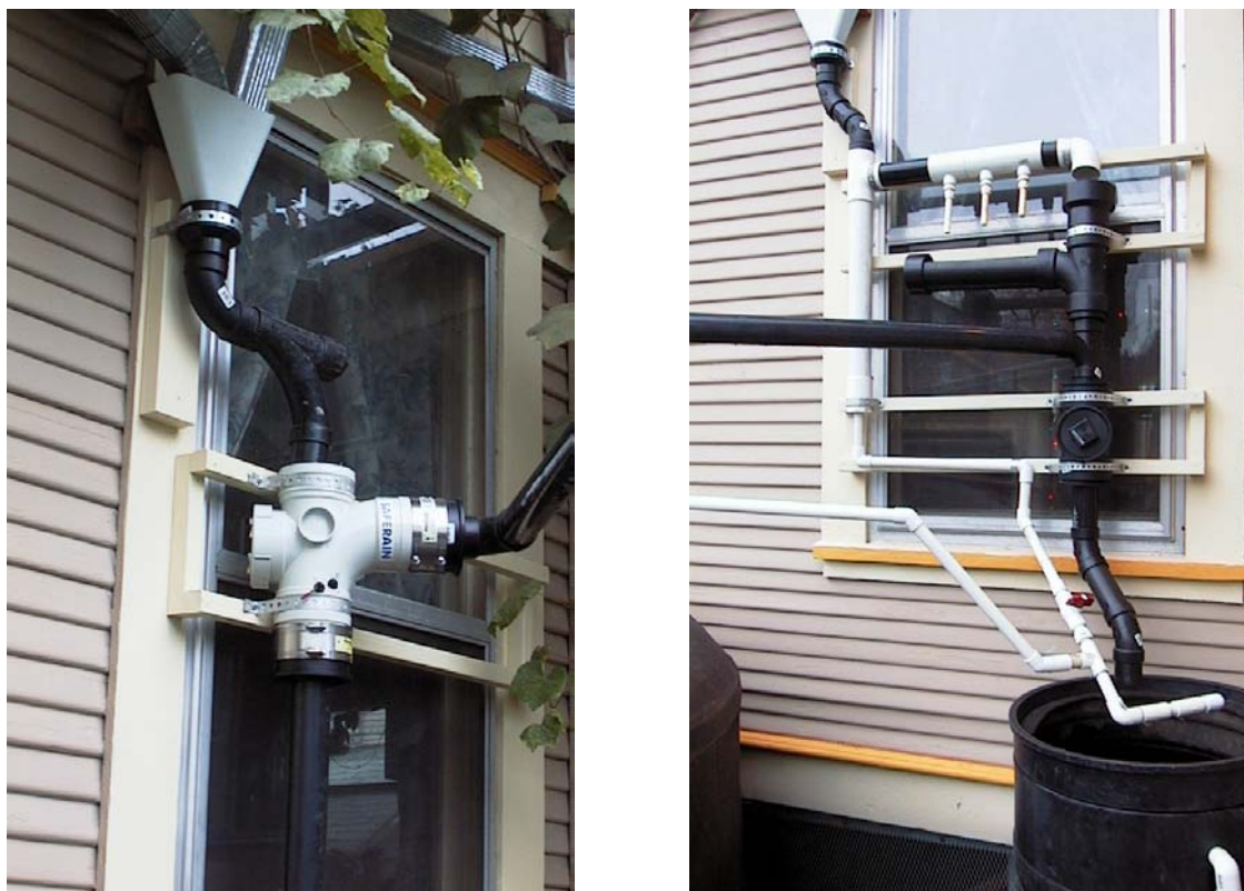
Figura 4: Equipamento para retirada da água de chuva que lava o telhado
