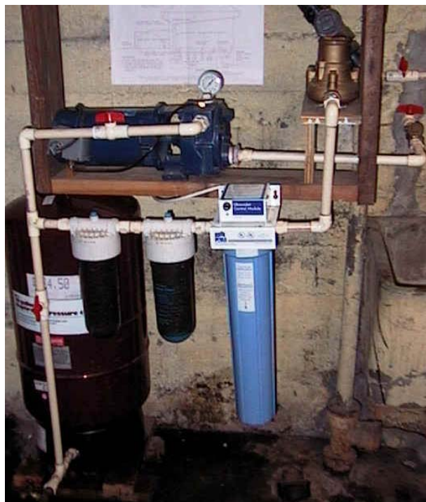
Figura 6: Bomba Pressurizadora de Água de Chuva, Filtros e Sistema de Desinfecção Ultravioleta.
