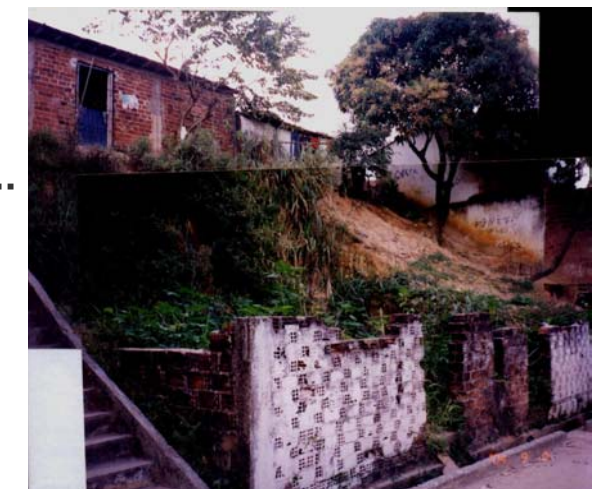
Morador tentou construir cortando o talude que acabou cedendo e atingindo uma pessoa. Rua Jerônimo de Barros, fundos do lote da rua Luis Rodrigues de Melo, 165.
