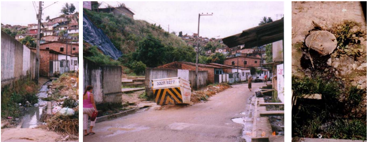
ILUSTRAÇÕES 72: Esgoto in natura transborda na canaleta da rua Antônio Carneiro, após chuva forte. ILUSTRAÇÃO 73: Rua Antônio Carneiro com fossa coletiva à esquerda e canal de drenagem à direita. ILUSTRAÇÃO 74: Esgoto transborda e invade canaleta de drenagem da rua Lisboa de Moura. Fonte: fotos da autora, 2004.
