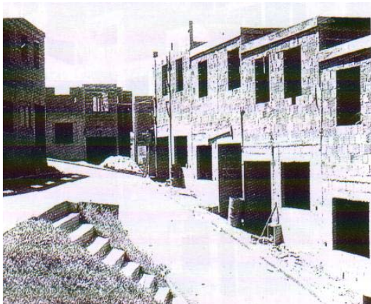
ILUSTRAÇÃO 21- Conjunto habitacional em São Paulo, construído em mutirão em 1992. Destaque para implantação das unidades escalonadas na encosta. Uma exceção à regra. Fonte: FARAH, 2003.
