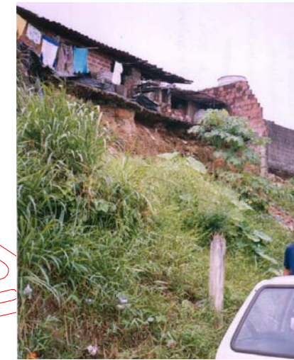
Laje sobre talude rompeu no final de 2003, levando ao deslizamento do talude. Fundos do lote da rua Carlos Mariguela, 286.
