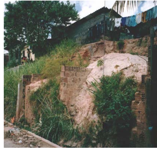
Morador resolveu construir cozinha cortando a encosta, o deslizamento soterrou a construção. Fundos do lote da Rua José Carlos da Mata Machado, 835.
