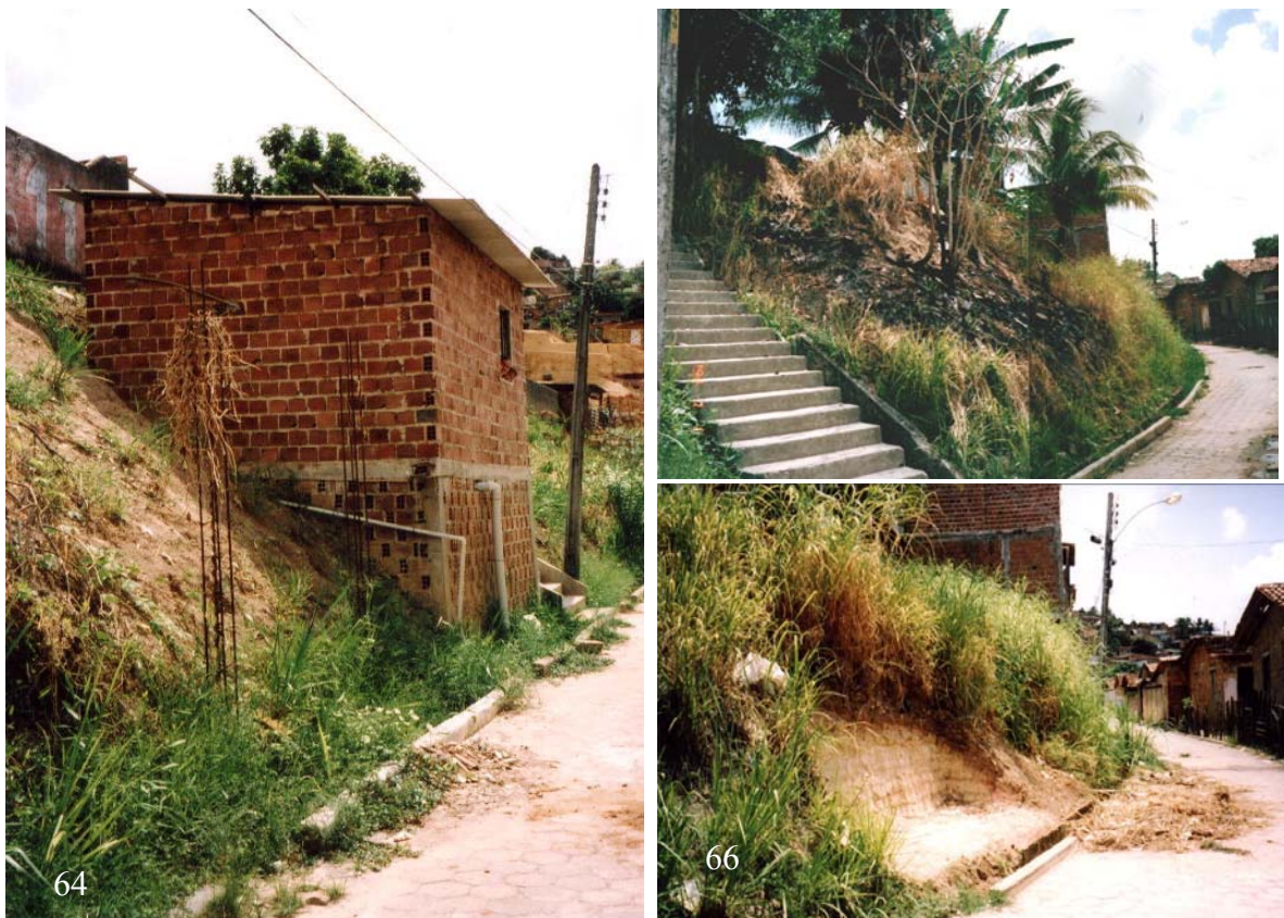
ILUSTRAÇÕES 64, 65 e 66: Intervenções que descaracterizam o conjunto e desestabilizam os taludes: desmatamento, queimada e retirada de barro. Fonte: fotos da autora, 2005.
