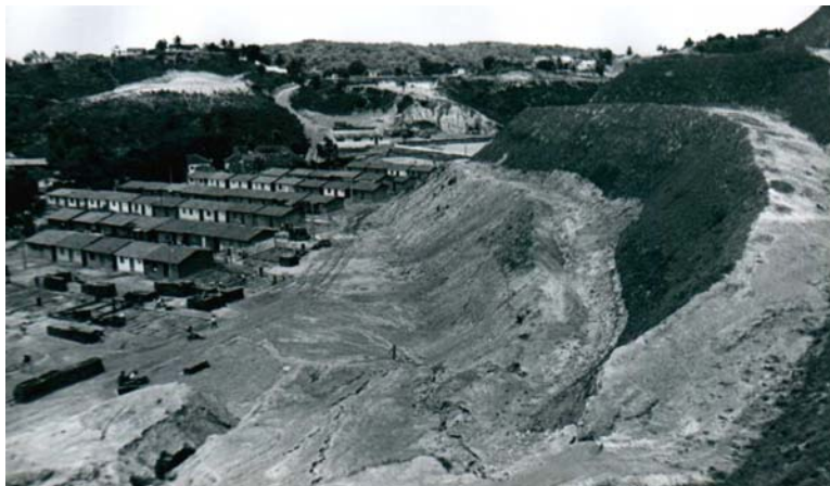
ILUSTRAÇÃO 41: Terraplenagem realizada de cima para baixo. À medida que ia surgindo o novo perfil, as encostas iam sendo protegidas com a vegetação, não tendo sido utilizadas contenções temporárias. Fonte: Selma Arteiro, [1990?].
