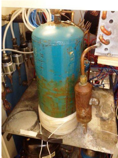
Figura 4.19 – Resistor aquecedor de revestimento de silicone, instalado em torno da base do reservatório.
