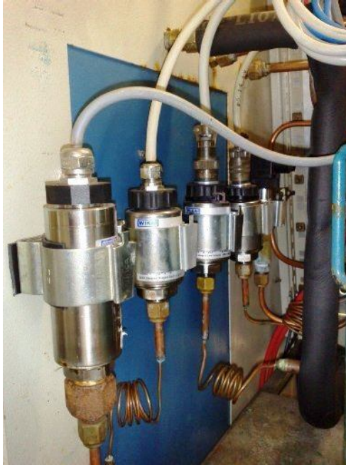
Figura 4.5 – Transmissores de pressão WIKA instalados na bancada protótipo.
