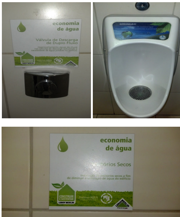
Figura 29 – Fotos dos equipamentos e identificações dos dispositivos economizadores da loja.
