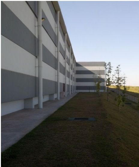
Figura 20 – Fotos do pátio interno com a rede de drenagem e das descidas de água pluvial da cobertura.
