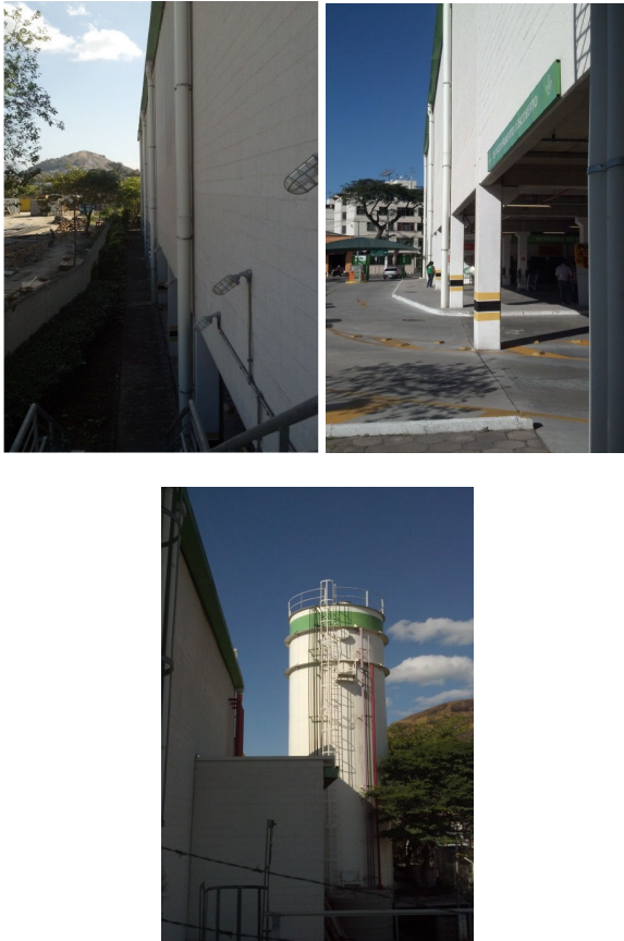
Figura 31 – Fotos da rede de captação de água de chuva e do reservatório superior.
