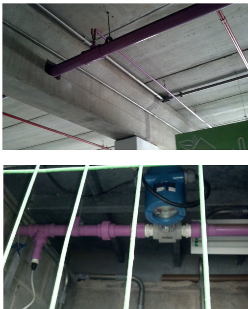
Figura 33 – Fotos da rede de distribuição da água de chuva (cor lilás) e do medidor específico.
