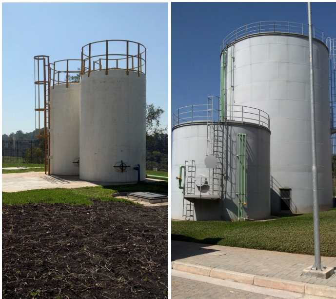
Figura 26 – Foto do reator UASB e tanque aeróbio utilizado na Etac e os dois reservatório de água, sendo o de 87 m 3 para água do poço artesiano e água potável e o maior de 715 m 3 para água de reuso.
