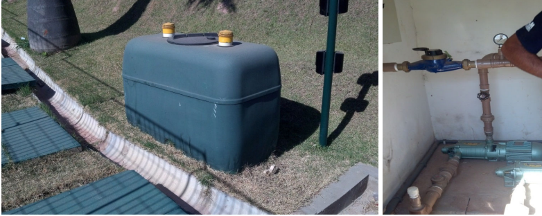
Figura 22 – Foto do equipamento utilizado no tratamento de águas cinzas e do hidrômetro de controle exclusivo para a água de reuso.
