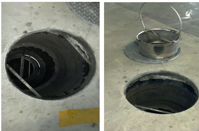
Figura 32 – Fotos do poço de vista do reservatório inferior de água de chuva e do gradeamento.
