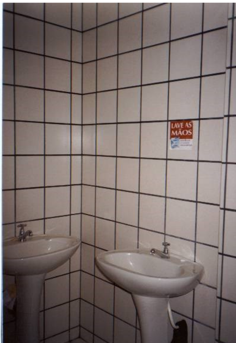
Fotografia nº 4 – Lavatório do HMMKB - Ausência de material para limpeza, enxugo e secagem das mãos
