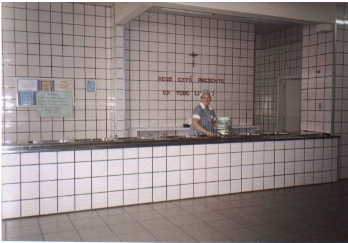
Fotografia nº 15 – Balcão térmico localizado no refeitório do HMMKB
