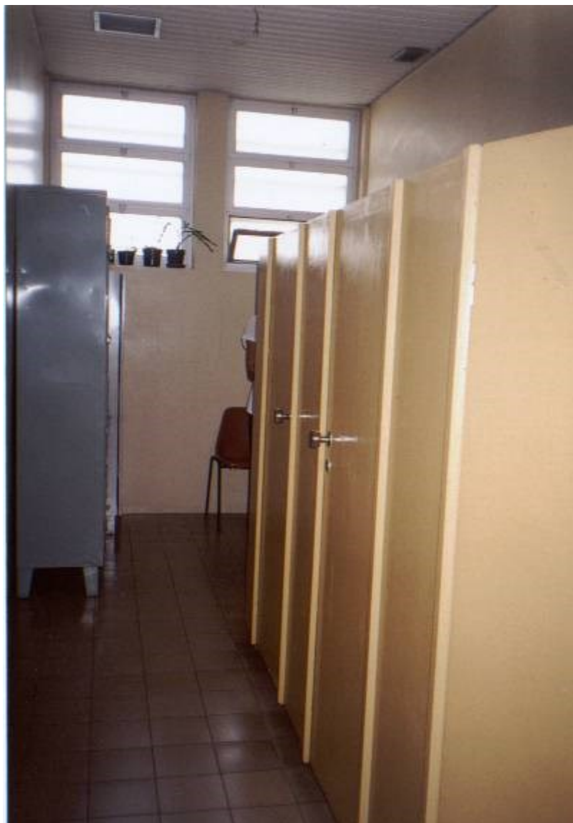
Fotografia nº 6 – Gabinetes sanitários do HMMKB obedecendo as recomendações da NR 24
