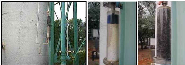
Figura 4 - Sistema de purificação do biogás.
