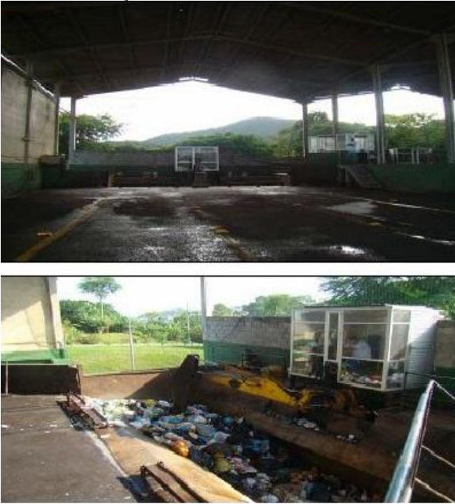
Figura 18-ET atual: Plataforma de descarga dos resíduos e acomodação dos resíduos com braço mecânico.
