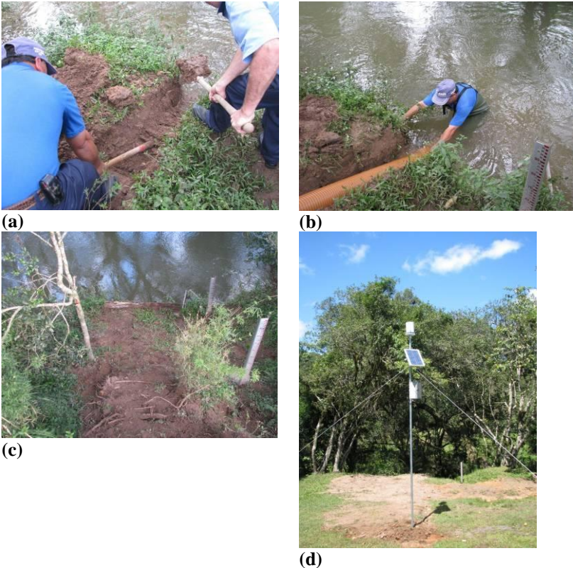
Figura 5.10 - Instalação da estação hidrossedimentológica do ponto de estudo RB01. (a) Abertura de uma vala para colocação do tubo; (b) Tubo colocado na vala e (c) enterrado; (d) Estação instalada
