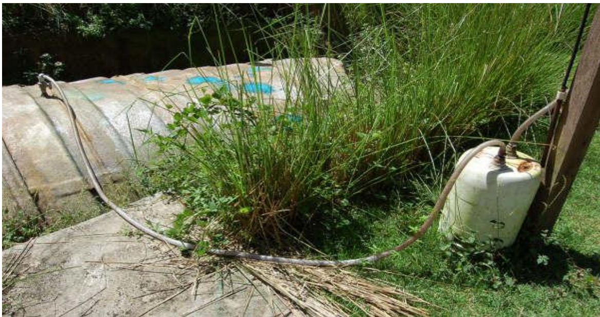
Fig. 12: Biodigestor, evidenciando a saída de gás.
