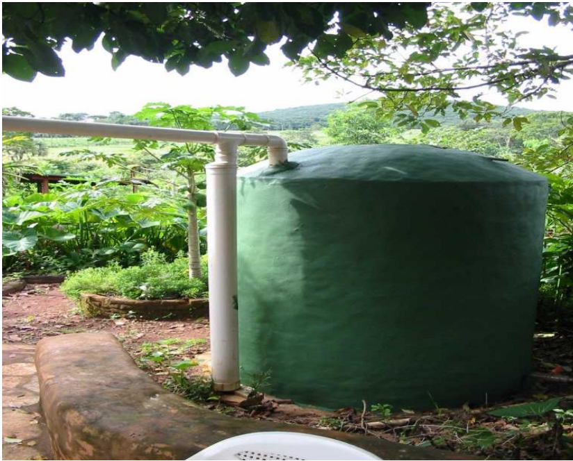
Fig. 6: Filtro acoplado à cisterna
