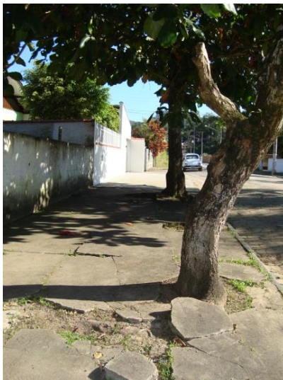
(b) Passeio público arborizado, mas sem execução de caixa de árvore.
