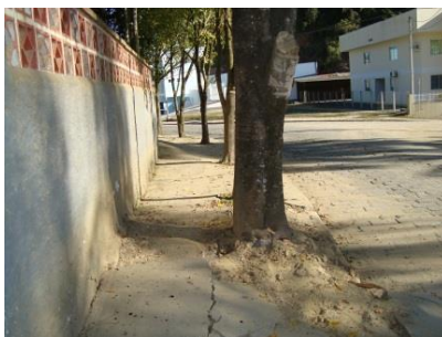
(b) Passeio público com largura não recomendada para arborização urbana.
