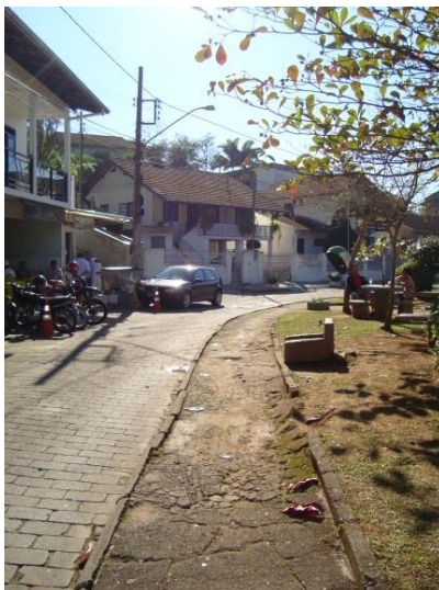
(d) Passeio público com revestimento solto e rachaduras.
