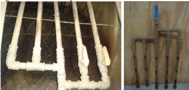
Figura 7 - Sistema de aspersão de lixiviado.
