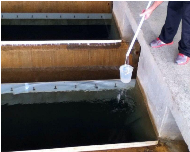
Figura 6. Local de coleta da ETA Morro dos Quadros: Água coletada após filtragem ascendente.
