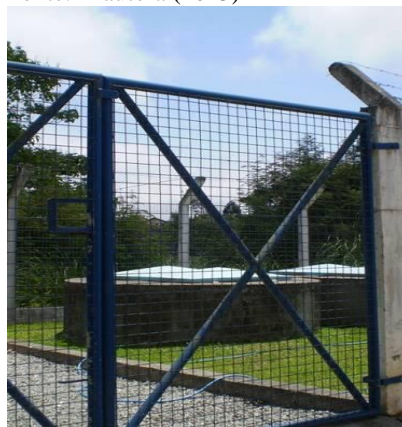
Figura 21 – Vista geral de uma Estação Elevatória do Sistema 2 Fonte: A autora (2013)
