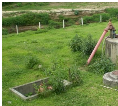
Figura 19 – Estação Elevatória do Sistema 1 Fonte: A autora (2013)
