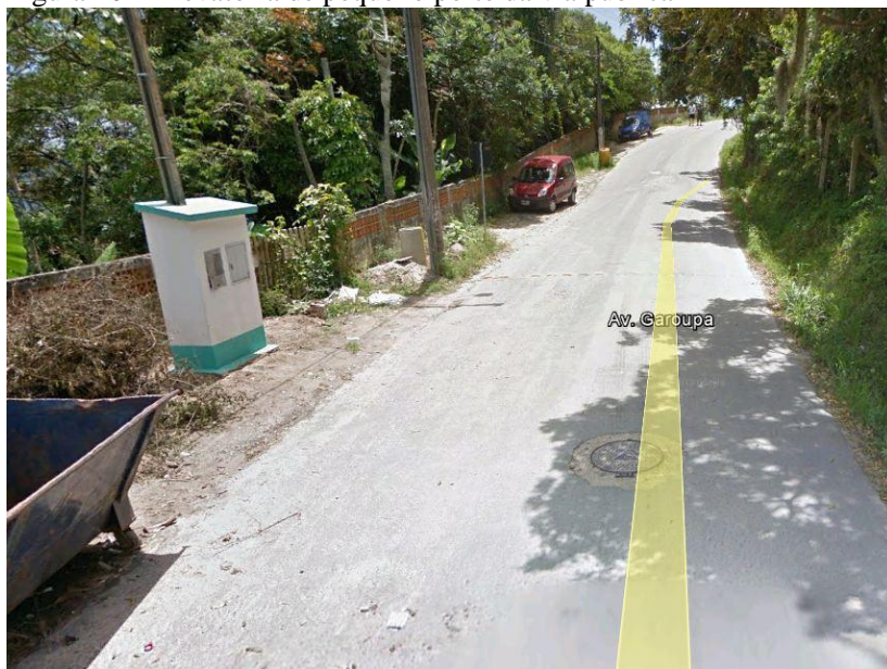
Figura 10 – Elevatória de pequeno porte da via pública
