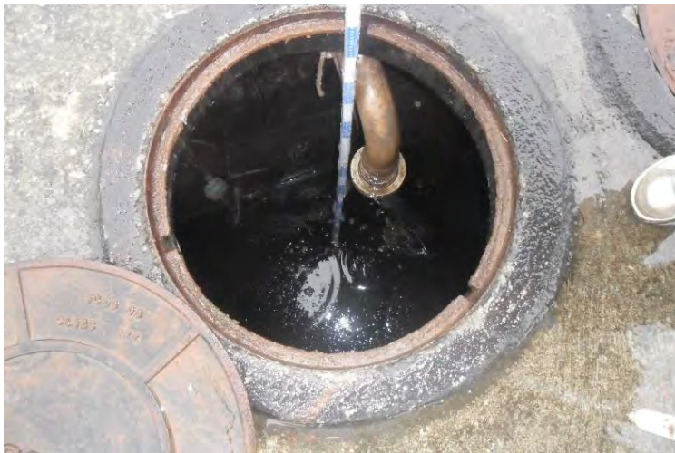
Figura 13 Medições do nível de esgoto dentro do último compartimento do RAC
