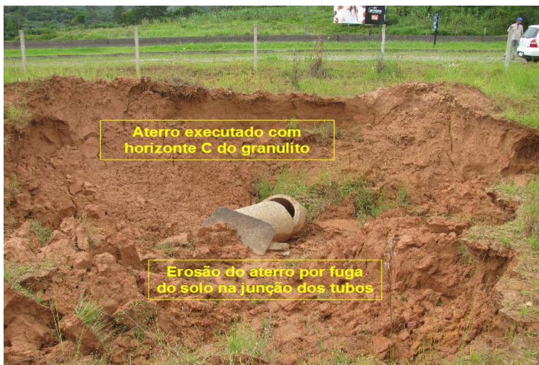
Figura 3.5.21: Bueiro rompido devido a fuga do aterro executado com o horizonte C do granulito, pela junção dos tubos
