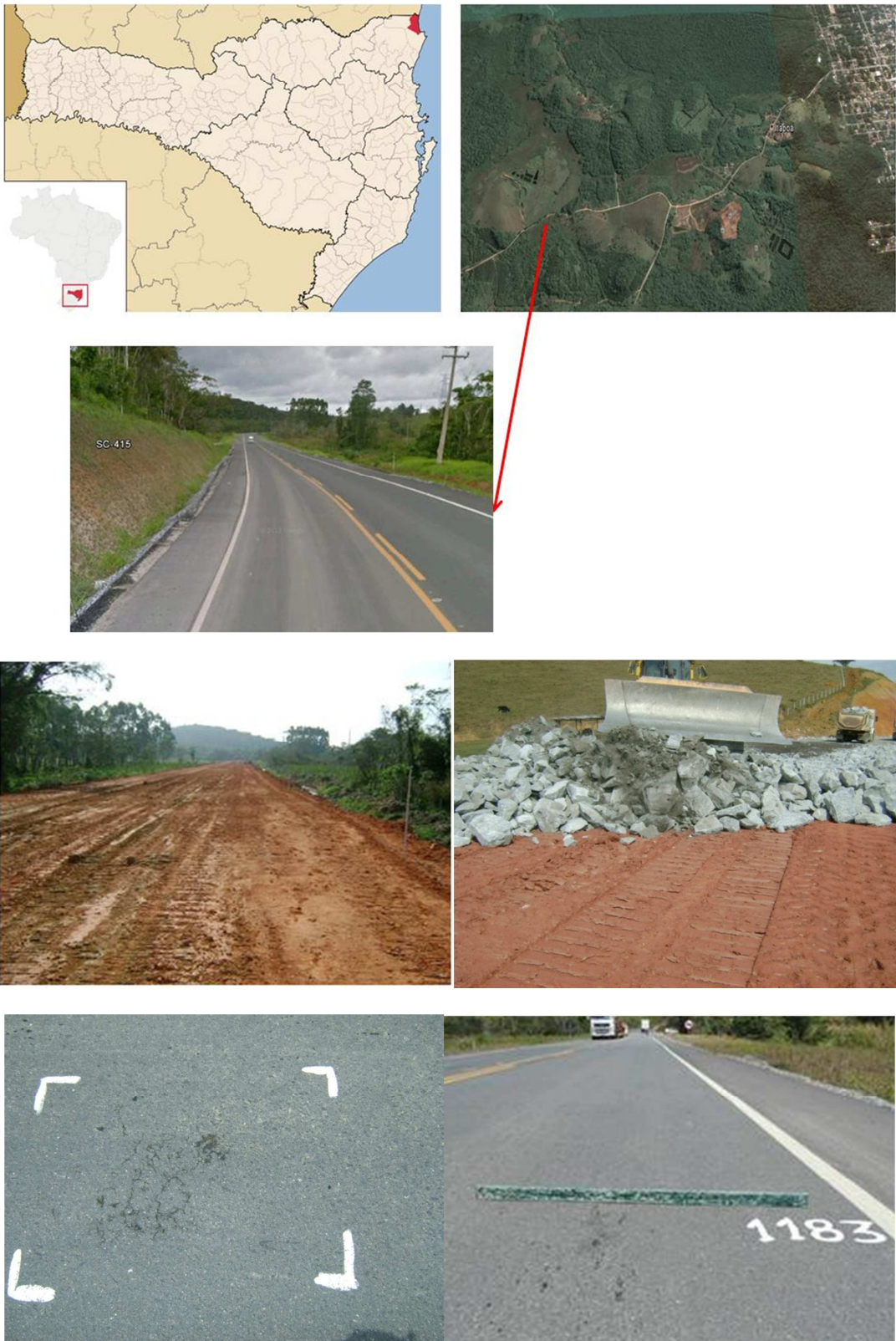
Figura 13 - Informações visuais do Segmento Monitorado em Itapoá e levantamento de patologias realizado em 2012
