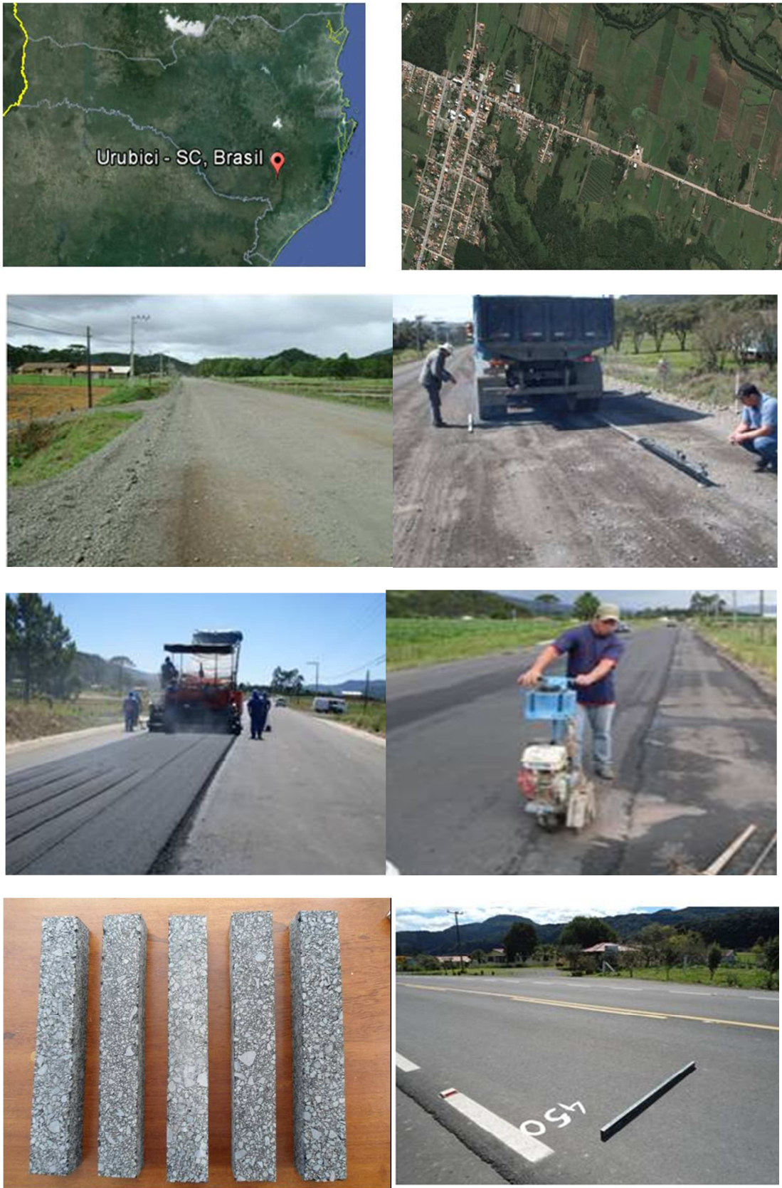
Figura 12 - Informações visuais dos Segmentos Monitorados em Urubici. Construção, retirada de placas para ensaios de deformação permanente e resistência á fadiga e levantamento das patologias
