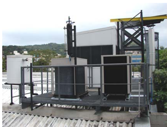
Chillers de absorção água-amônia
