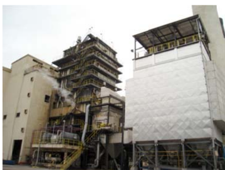
Planta termelétrica 50 MW (90 bar; 515°C) a carvão pulverizado, utilizada nos testes com palha de arroz em processo cofiring : P&D ANEEL 0403-0005/2008 Convênio Tractebel/FEESC UTLA.NAJL.09.51969
