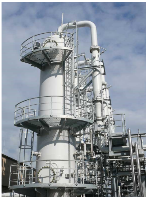
Figura 8 Torre de desidratação.
