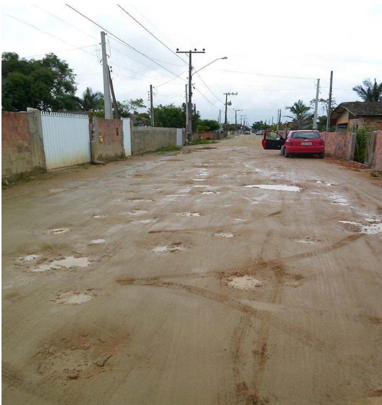
Figura 31 - Ausência de pavimentação no Jardim Progresso. Fonte: Acervo pessoal, dez./2013.
