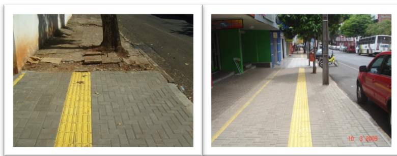
Figura 6: Descontinuidade da calçada e do piso tátil.
