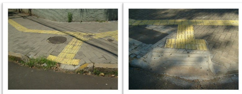
Figura 7: Rampas fora da Norma Técnica
