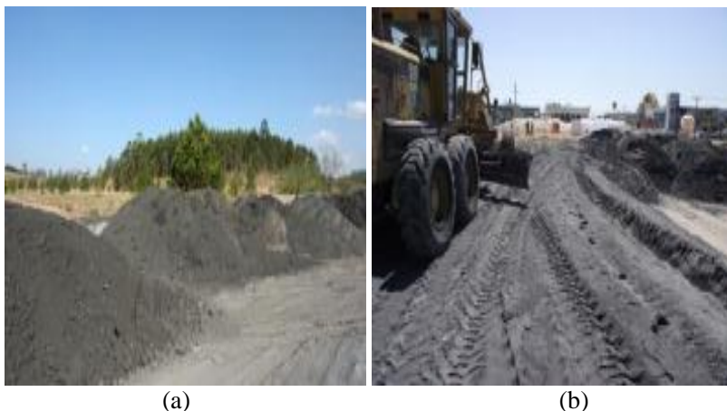
Figura 6 - (a) Descarte e depósito de cinzas pesadas em bacias de sedimentação (SILVA, 2011), e (b), utilização da cinza como material para aterro (BR 101 SUL, 2013)
