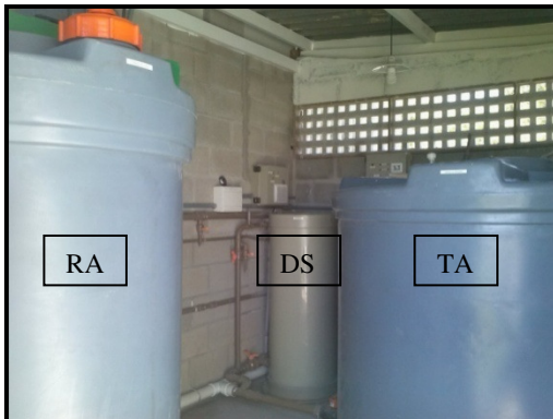
Figura 4. Disposição do tanque de aeração, decantador secundário e reservatório de ácido fólico.
