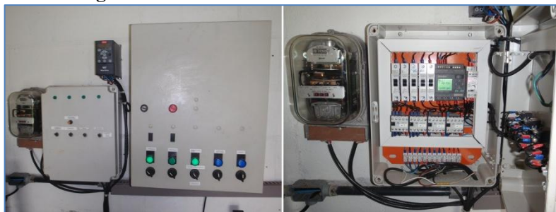
Figura 12 – Painel de comando eletrônico com CLP.
