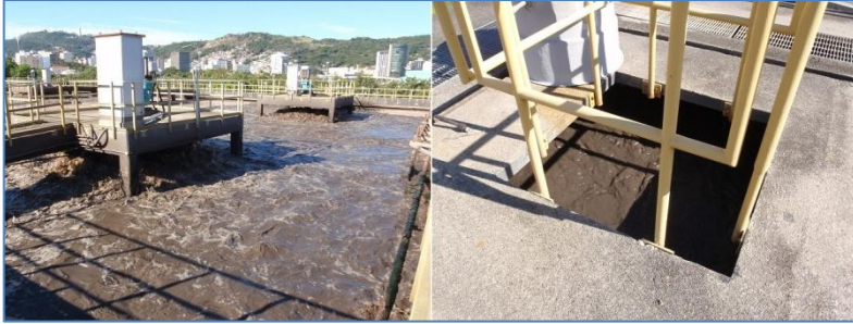
Figura 8 – Tanque de aeração (esquerda) e linha de distribuição (direita) da ETE Insular.
