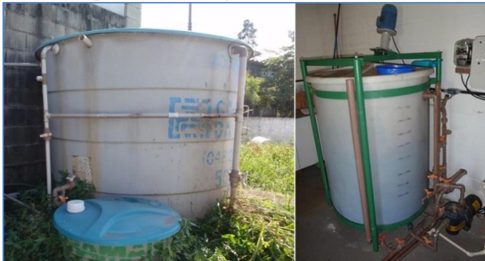
Figura 6 – Tanque externo de armazenamento (esquerda) e tanque interno de equalização com agitador mecânico (direita).
