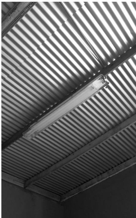
Figura 12: Inadequação da luminária do galpão de matéria prima. (Antes)
