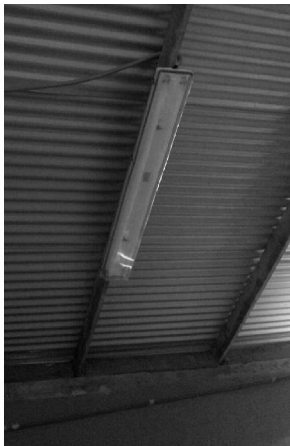
Figura 13: Modificação necessária na luminária do galpão de matérias primas. (Depois)
