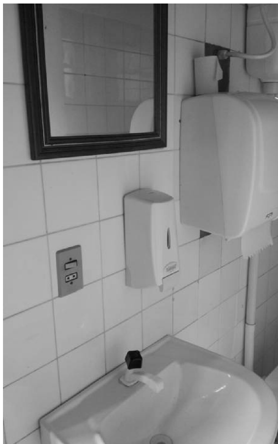
Figura 9: Inadequações no banheiro de visitantes. (Antes)
