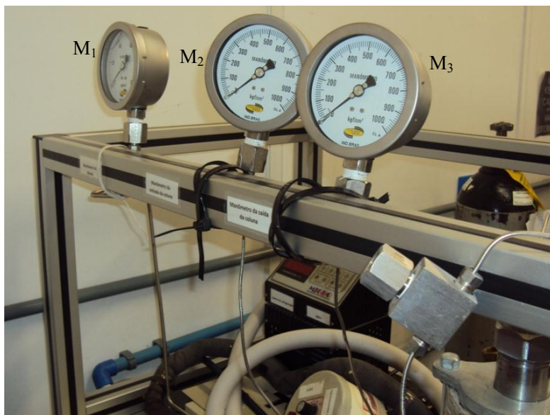
Figura 4.9: Instrumentos indicadores de pressão (Manômetros).
