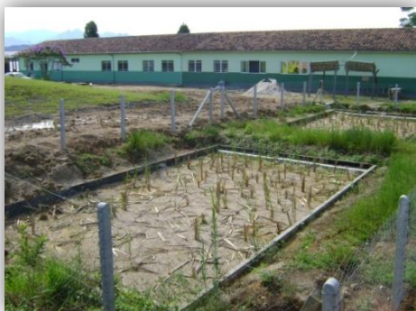
Figura 15 - Tratamento de esgoto em escola.
