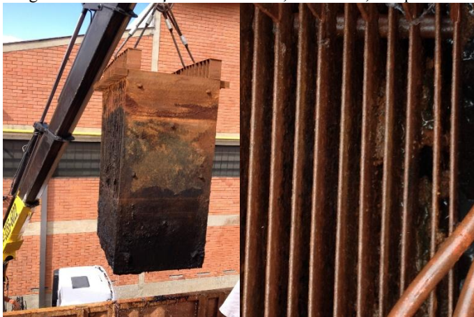
Figura 19 - Substituição dos eletrodos, no detalhe, entupimento.
