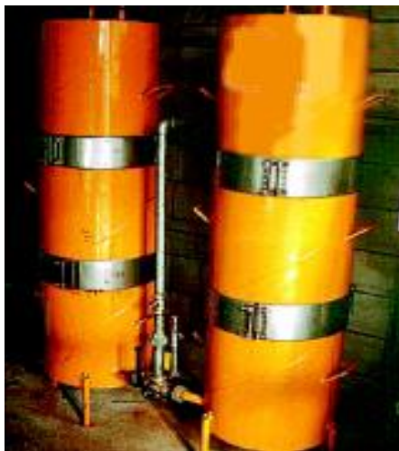
Figura 6 – Instalação de purificação de biogás com duas colunas de óxido de ferro em paralelo.
