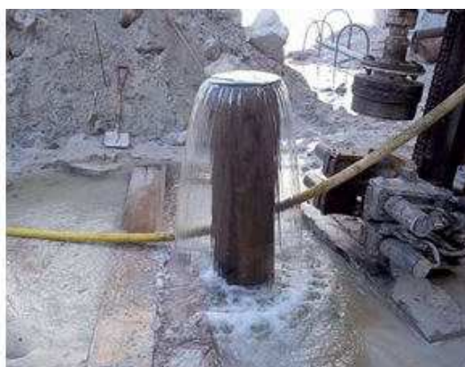
Figura 9: Extravasamento da água pelo tubo de instalação das estacas.
