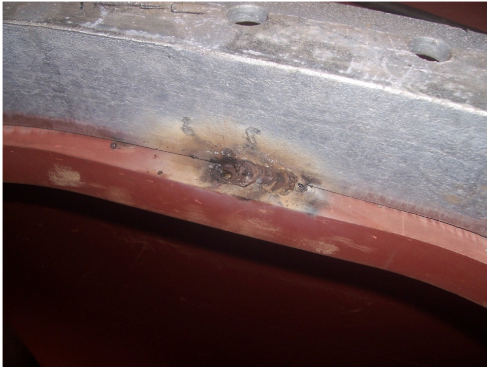
Figura 23 Pontos de fixação com descontinuidades
