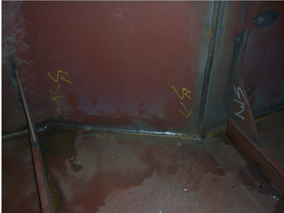
Figura 28 Ilustra alguns locais propícios de vazamentos
