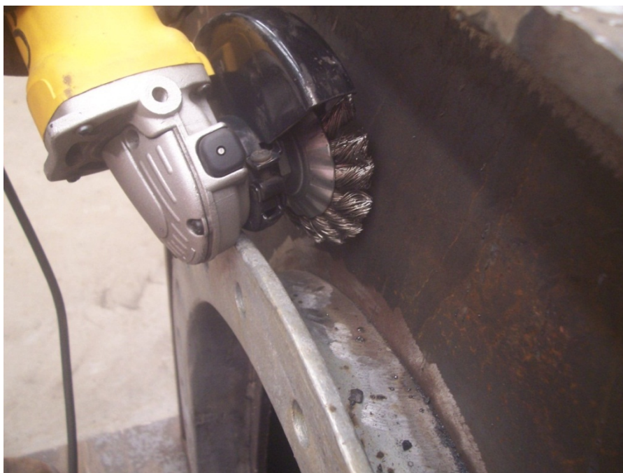
Figura 58 Obstrução do acesso da lixadeira à parte de trás do suporte
