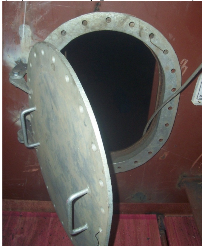
Figura 19 – Típica porta de visita de aço galvanizado nas embarcações do estaleiro
