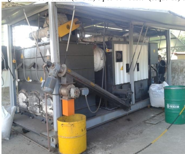
Figura 10 - Combustor (direita) e pós-combustor (esquerda) de lodo de esgoto.
