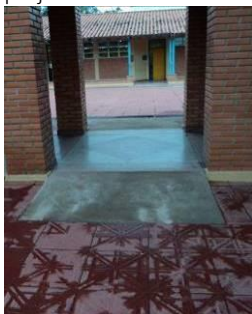
Figura 31 – Rampa do refeitório executada sem projeto.
