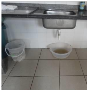
Figura 97 – Pias com vazamentos
