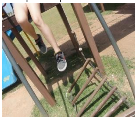
Figura 41 – Escada do brinquedo quebrada
