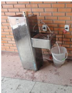
Figura 96 – Bebedouros com vazamentos
