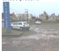
Figura 29 – Concregrama em estado precário
