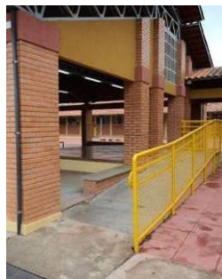
Figura 32 – Rampa de acesso ao palco executada sem detalhamentos
