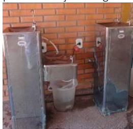
Figura 35 – Bebedouros com vazamento e baldes para contenção da água
