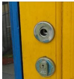
Figura 36 – Ausência de maçaneta na sala de aula do Bloco E2
