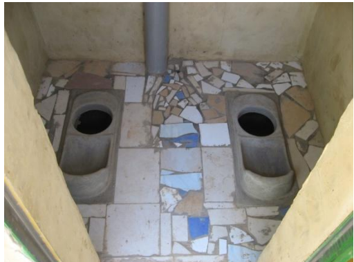
Figura 20 Banheiro seco para agachamento na África.
