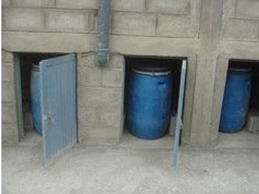
Figura 24 Recipientes móveis (bombonas) para armazenamento das fezes em BSVS.
