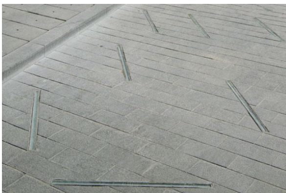
Figura 19: Tecnologia empregada permitiu que os equipamentos fossem embutidos no piso, não comprometendo a funcionalidade do lugar.
