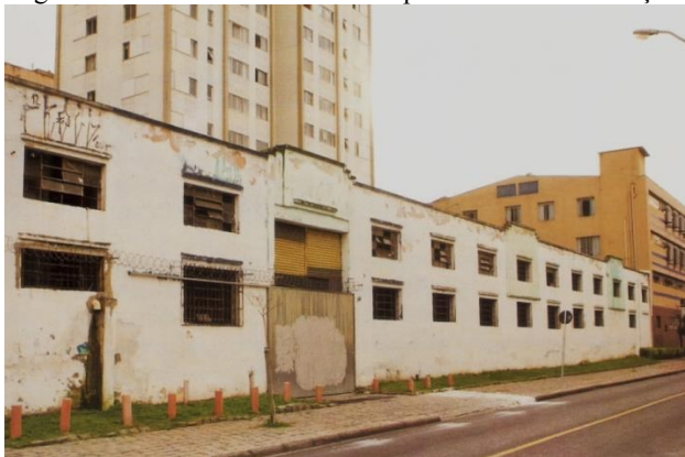
Figura 20: Imóvel subutilizado em processo de deterioração.
