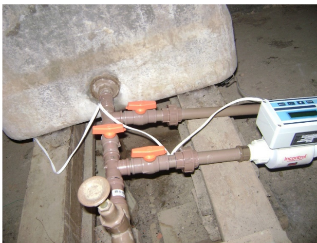
Figura 8. Medidor instalado na propriedade em estudo
