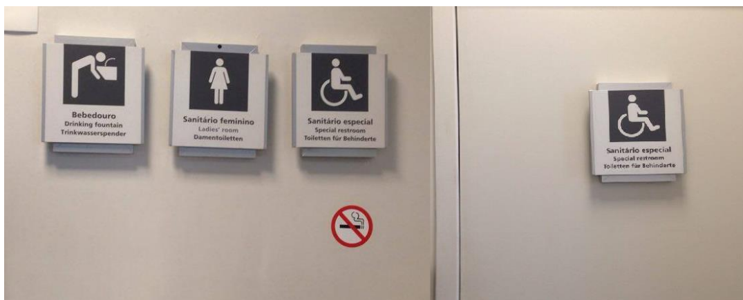
Figura 26 - Sinalização vertical dos sanitários PNAE
