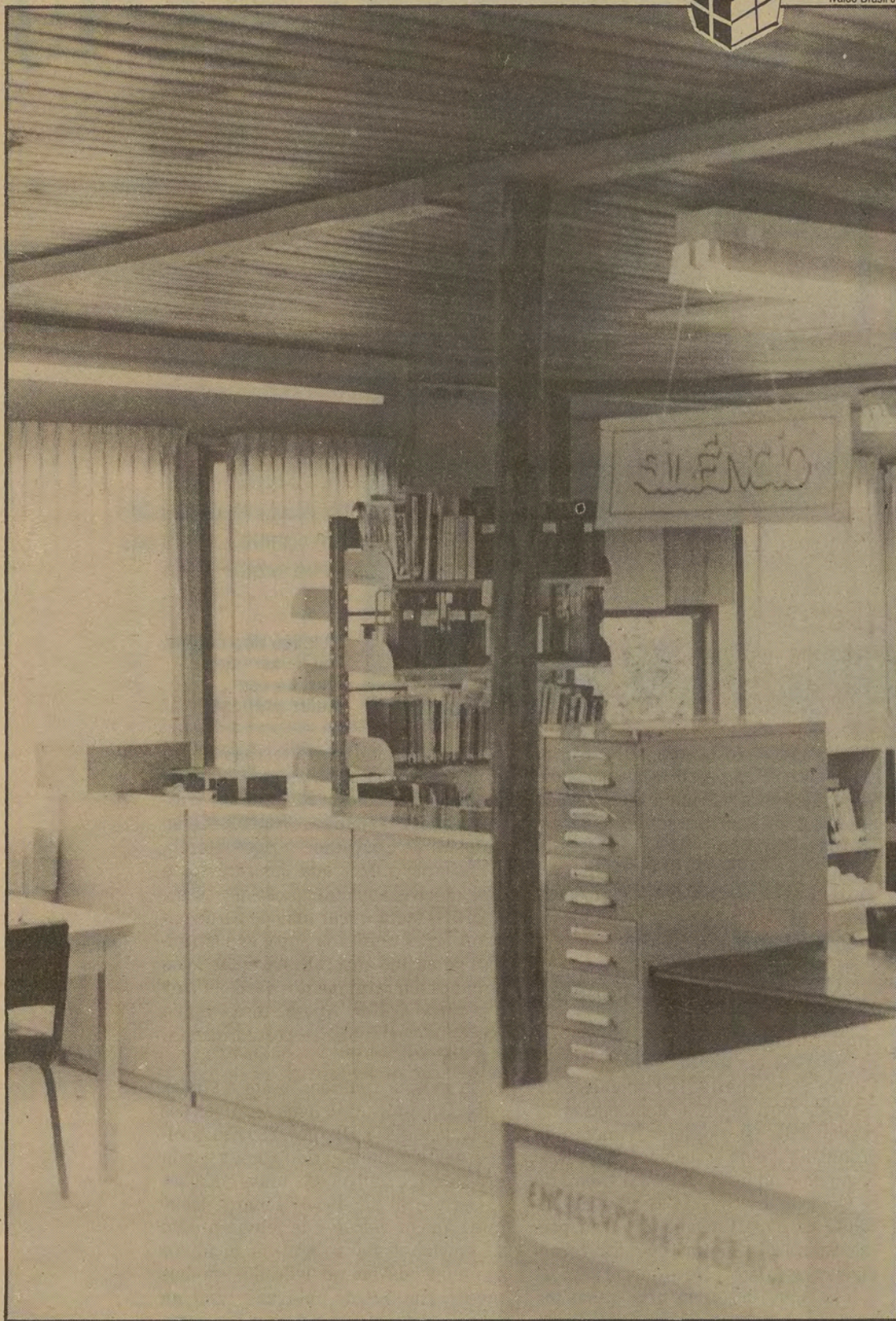
No CA, teto está caindo e teve que ser escorado provisoriamente com estacas
