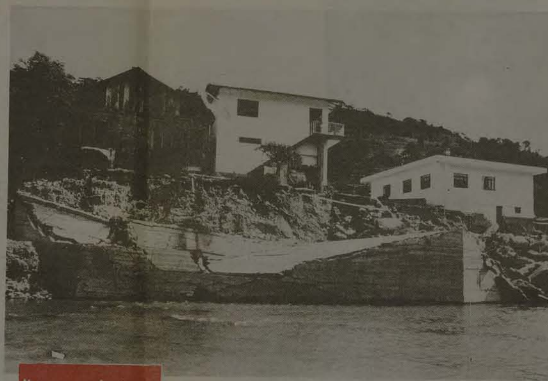
Nem o muro de cinco metros de altura foi suficiente para deter o avanço das águas
