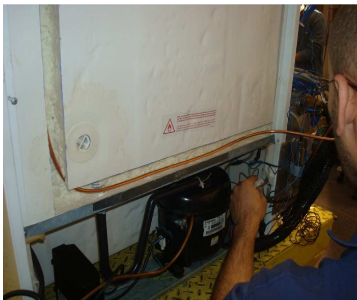
Figura 4.15 Montagem do trocador tubo capilar – linha de sucção.
