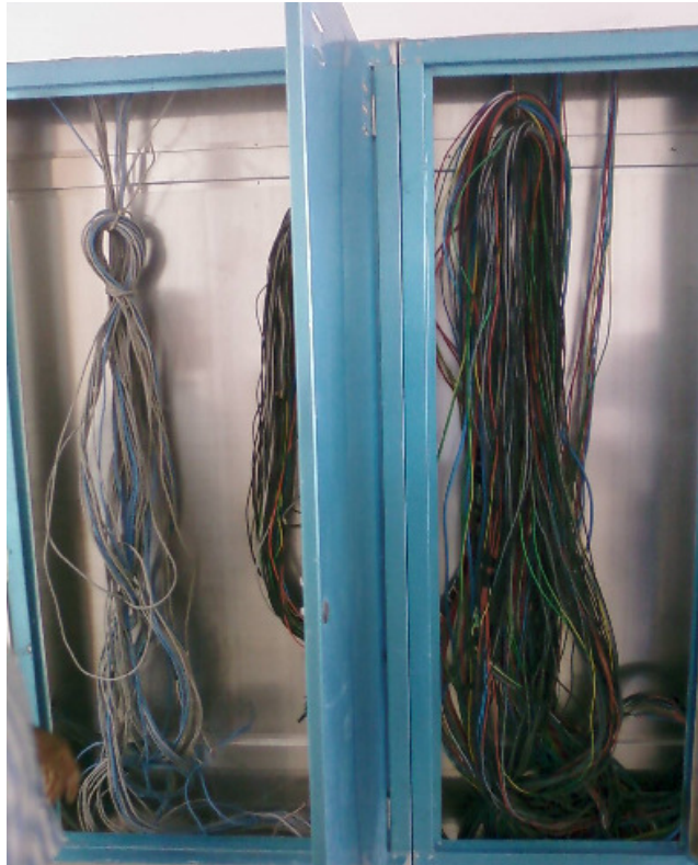
FIGURA 34 – Quadro de Automação e Distribuição – Etapa 01
