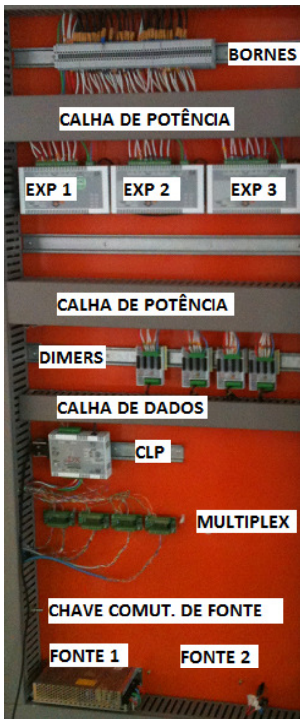
FIGURA 41 – Quadro de Automação Identificado
