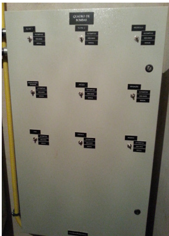
FIGURA 42 – Tampa do Quadro de Bombas
