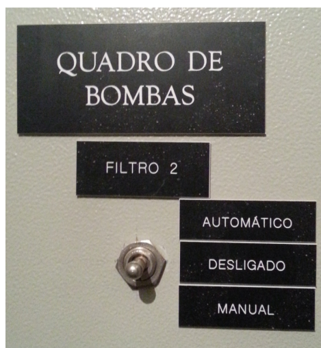
FIGURA 43 – Detalhe do Quadro de Bombas
