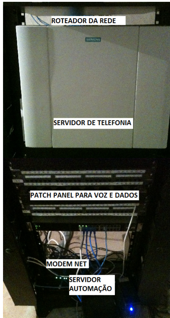
FIGURA 19 – Foto do Rack da Sala Técnica
