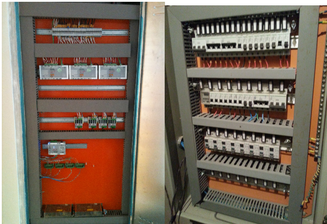
FIGURA 39 - Quadro de Automação e Distribuição – Etapa 04
