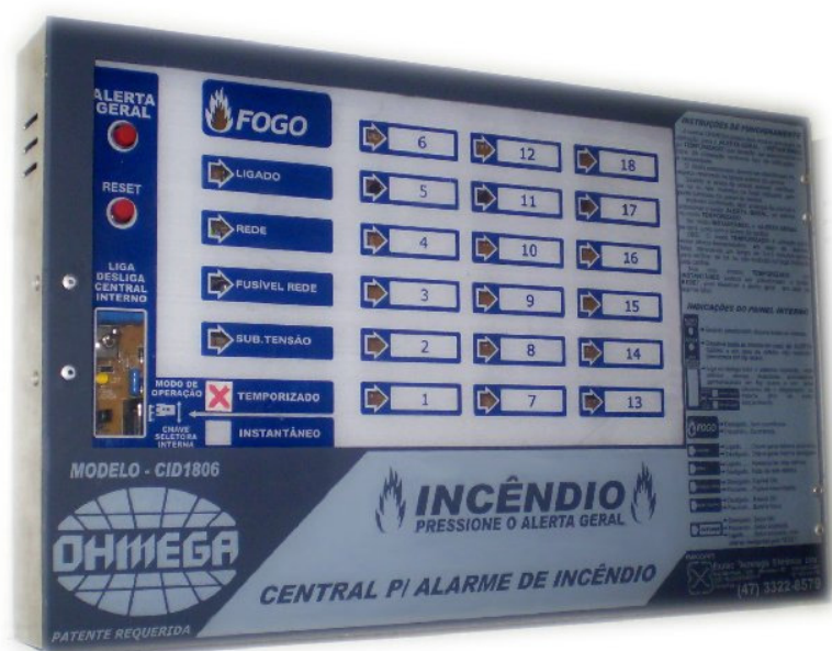
FIGURA 11 – Central de Incêndio usada no Projeto
