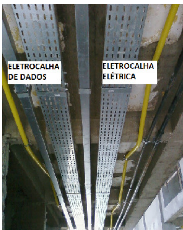
FIGURA 33 – Eletrocalhas de Dados e Elétrica
