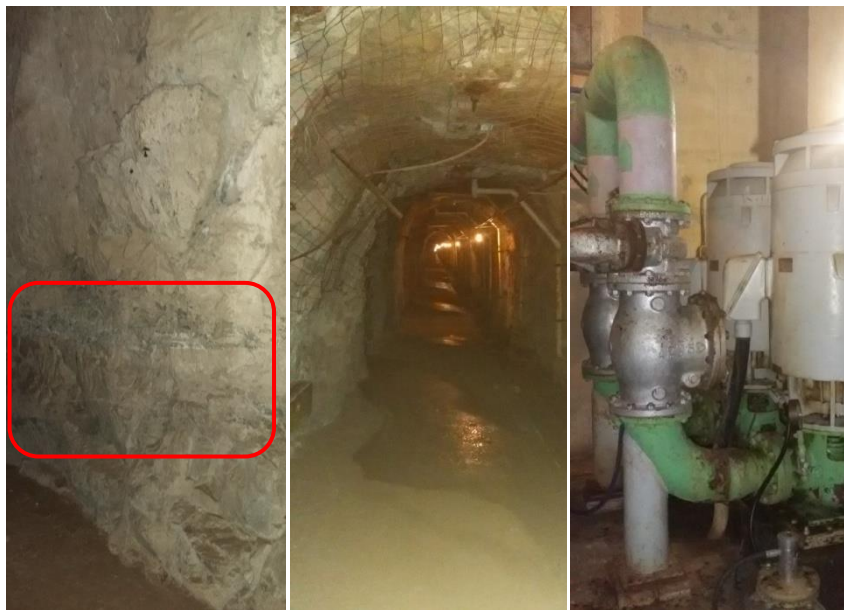
(a) Falha da Lagoa (b) Túnel ao sob a fundação (c) Motobombas do sistema de drenagem do túnel.
