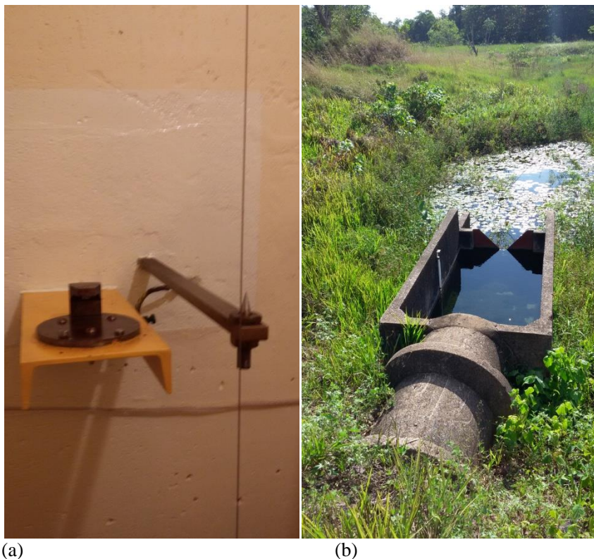
Figura 15 – Auscultação da UHE Tucuruí: (a) Pêndulo; e, (b) Medidor de vazão.
