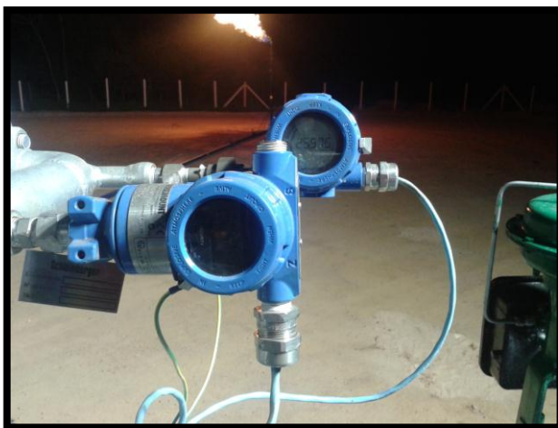
Figura A1.5: Transmissores de Pressão e Temperatura de Óleo
