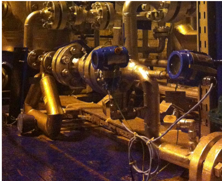
Figura 5.8: Sistema final de medição de água
