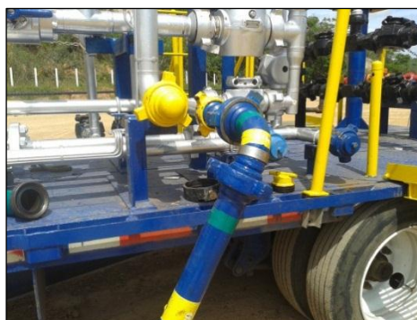
Figura 5.18: Conexão da saída de gás ao gás flare
