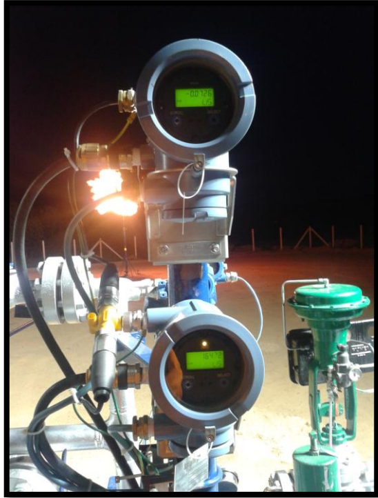
Figura A1.3: Transmissores de Vazão de Água e Óleo
