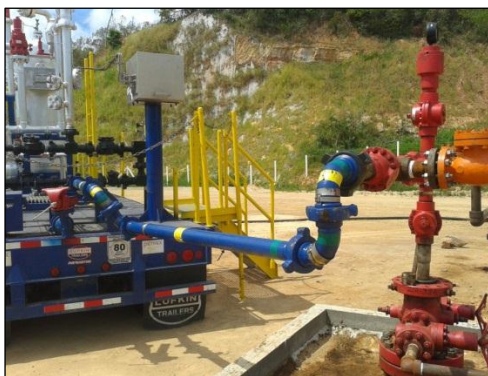
Figura 5.17: Conexão da Cabeça de poço ao Choke Manifold
