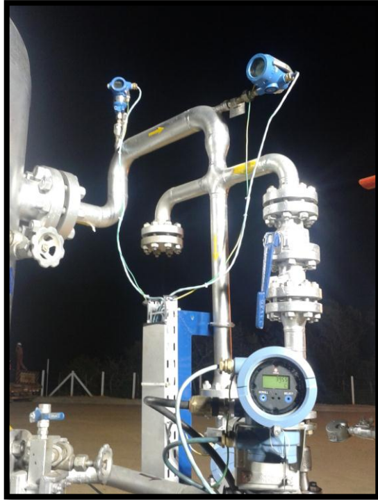
Figura A1.7: Transmissores de Pressão e Temperatura e Vazão de Gás
